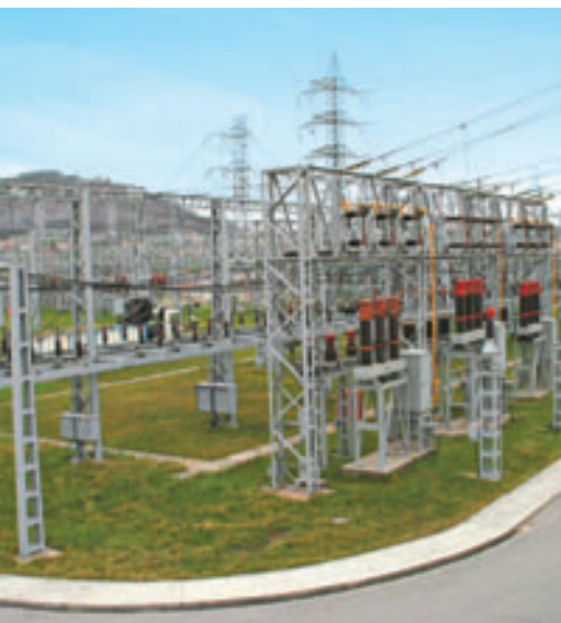
Un sistema de transmisión de energía de una ciudad tiene la función de bajar el voltaje para poder ser distribuido a los hogares.
